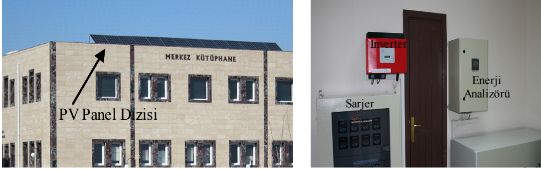
Şekil 2. Kütüphanede kurulu 3,5 kWp güçteki PV sistemin dış ve iç mekan fotoğrafları.
