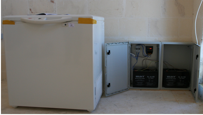
Buzdolabı-Solar kontrol ve batarya Grubu
